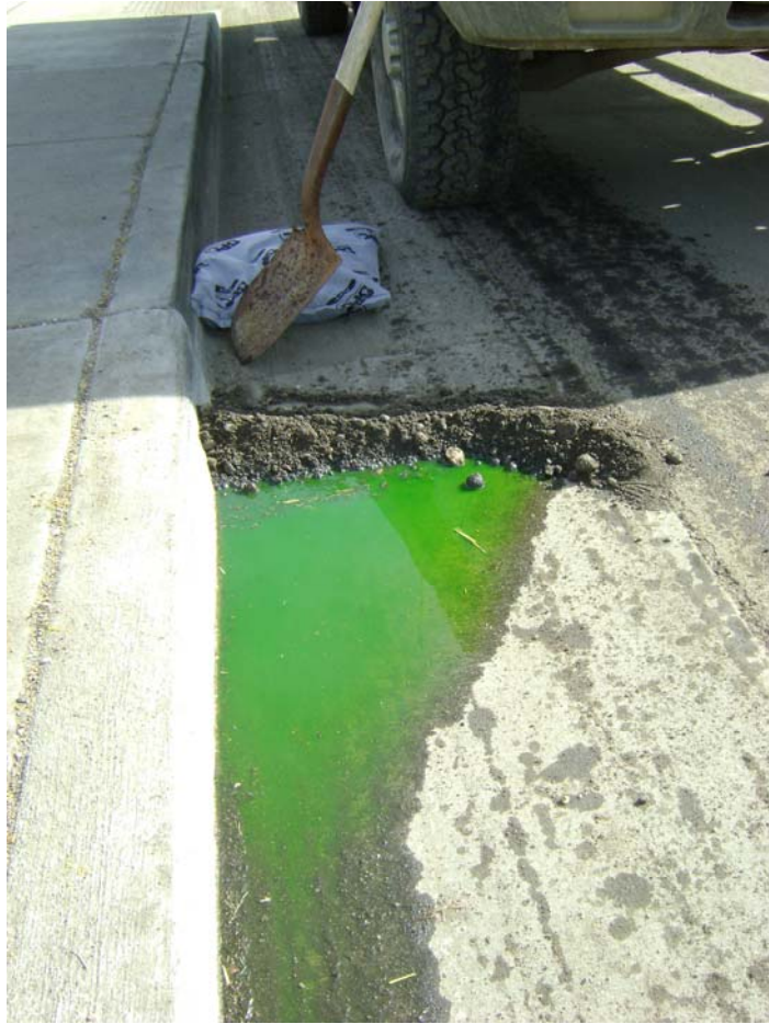
Stopping an antifreeze spill.
